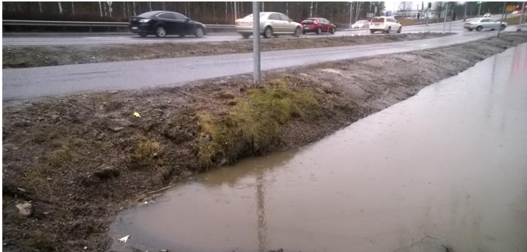
Kuva 6. Vt12 alittava 315PEH vaikutti maastokäynnin havaintojen perusteella olevan tukossa tai Vt12 pohjoispuolella mahdollisesti seisova vesi padotti läpivirtausta.
