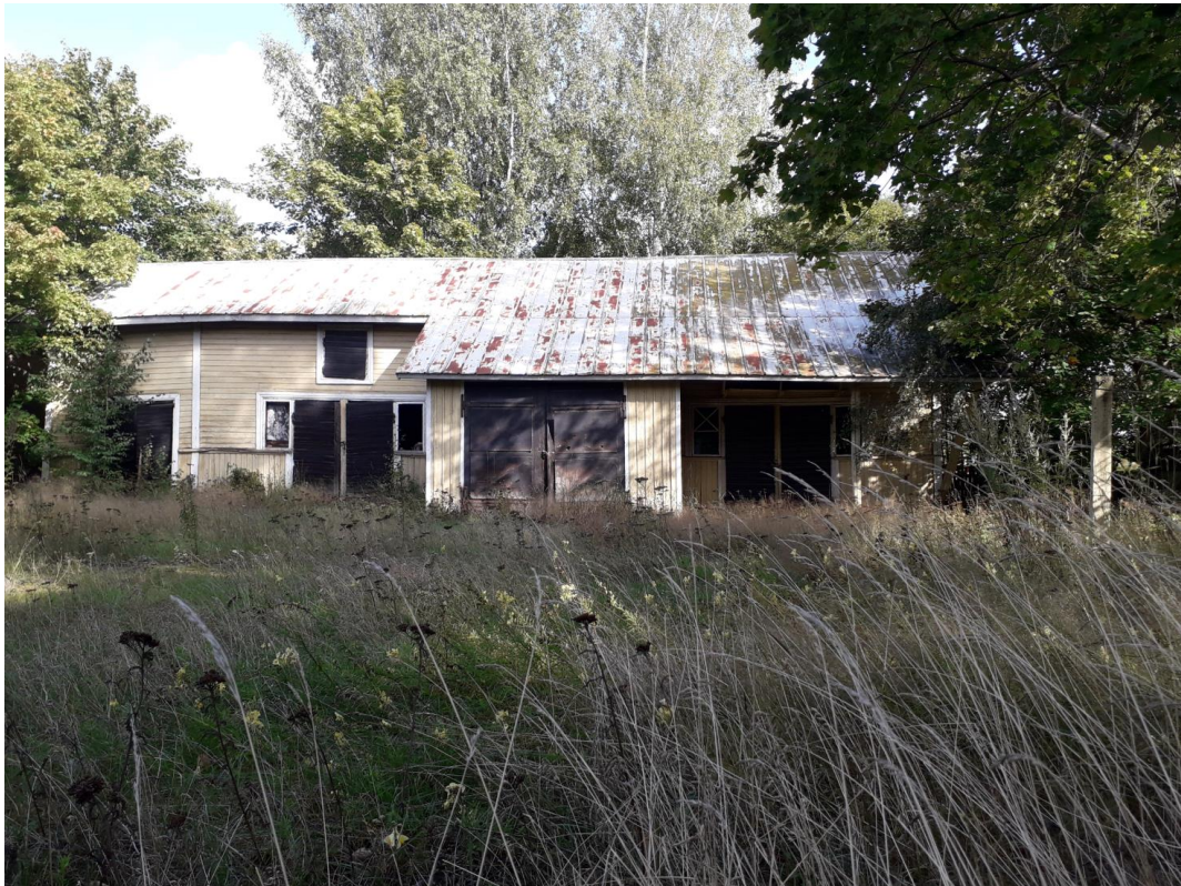
Pihoilla olevat puiset talousrakennukset ovat peräisin samalta ajalta kuin asuinrakennukset. Talousrakennuksiin on tehty muutoksia ja ne ovat huonokuntoisia.
