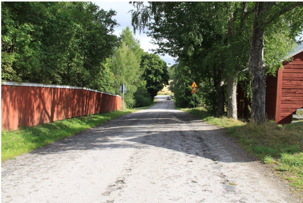
Kuva 19. Unajantie kylätontin kohdalla.
