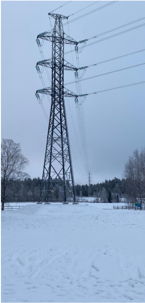
Kuva 3-5. Mallivalokuva vapaasti seisovasta kahden 110 kV virtapiirin vapaasti seisovasta voimajohtopylväästä. Kuva: TLT-Building Oy.
