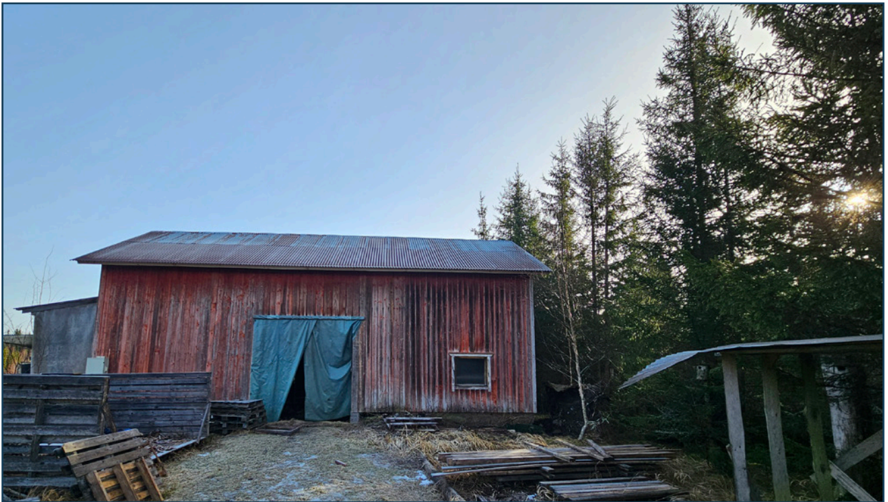
Kuva 15. Perkkotie 130 B. Piharakennuksissa oli home- ja kosteusvaurioita, mikä tekee niistä epäsuotuisan lepakoille.
