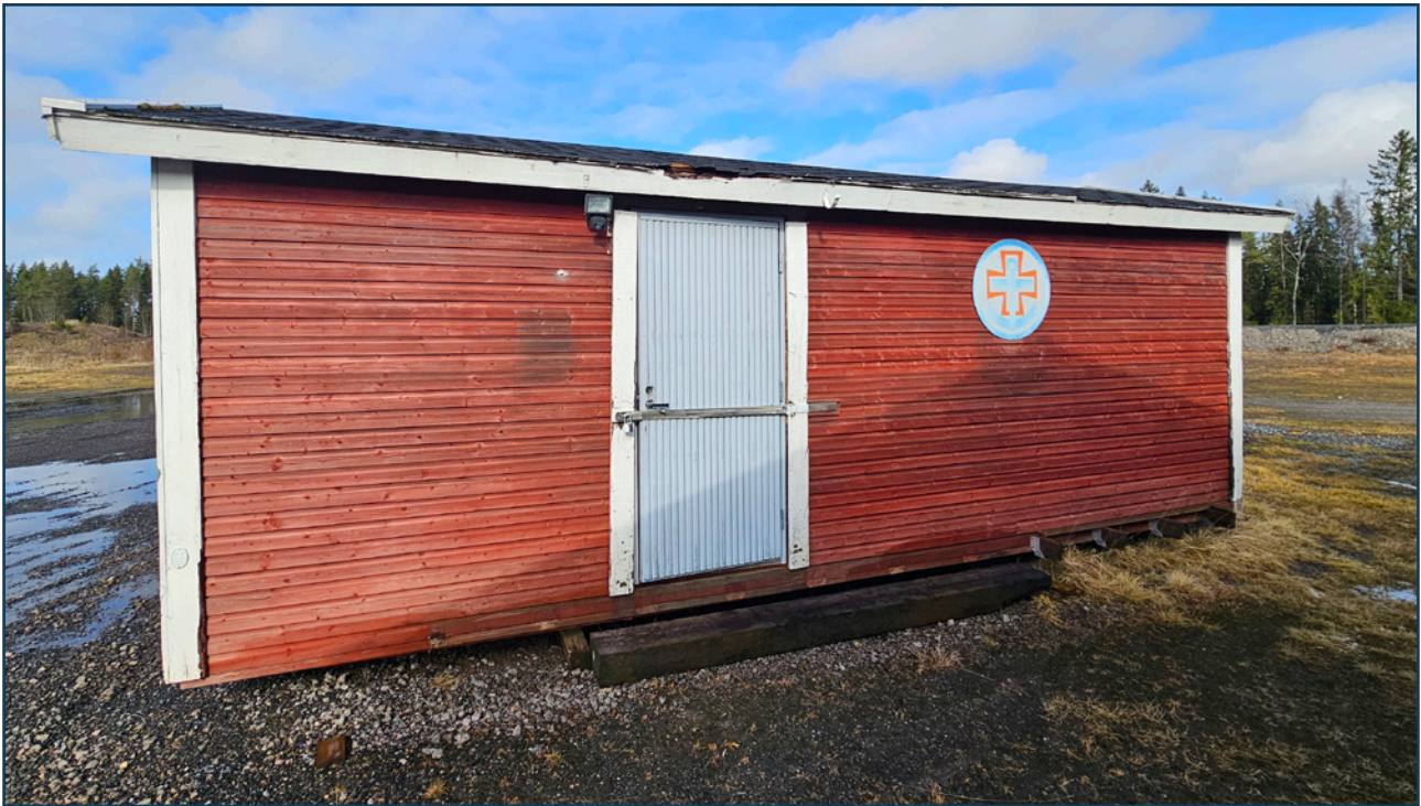
Kuva 18. Moottorirata. Punaisen rakennuksen kaikilla nurkilla oli hiiren/myyrän jätöksiä.
