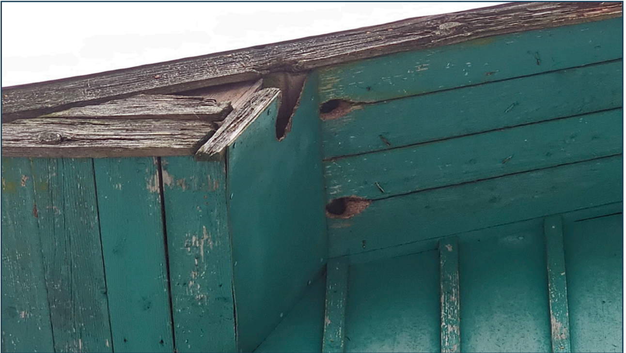
Kuva 5. Koiviontie. Räystäiden tikankolot on tutkittu tarkastuskameralla.
