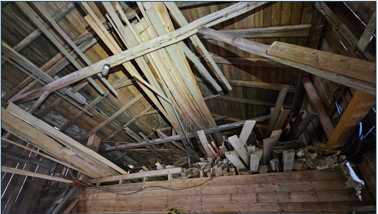
Kuva 16. Perkkotie 130 B. Varastorakennuksen ylisää ei päästy tarkastelemaan turvallisuussyistä.
