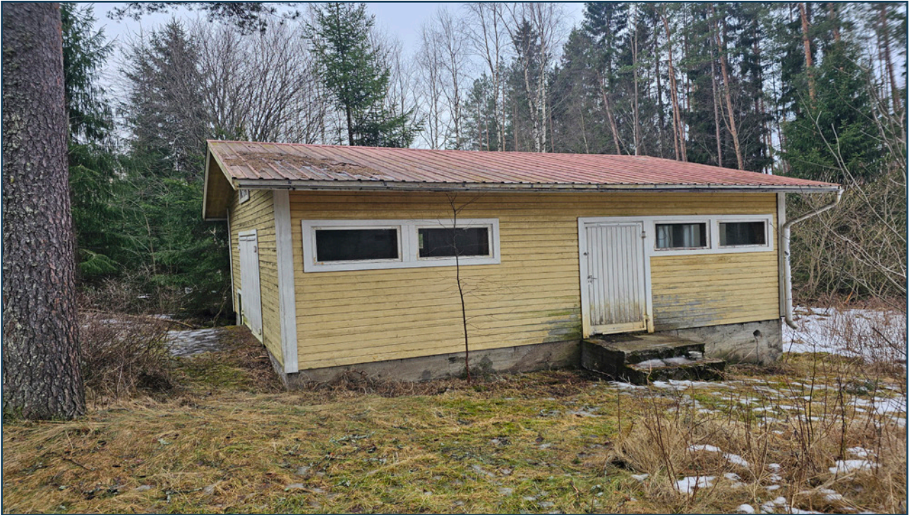
Kuva 8. Kuivassuontie 2. Huonokuntoinen piharakennus.
