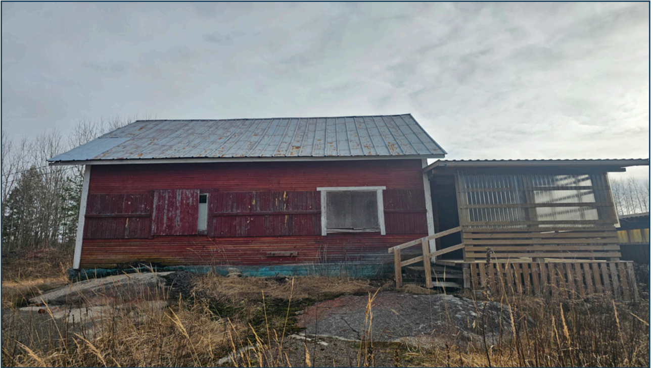
Kuva 22. Ampumarata. Päärakennuksessa oli lepakonmentäviä koloja, mutta myös kosteus- ja vesivahinko, mikä ei sovellu lepakoille.
